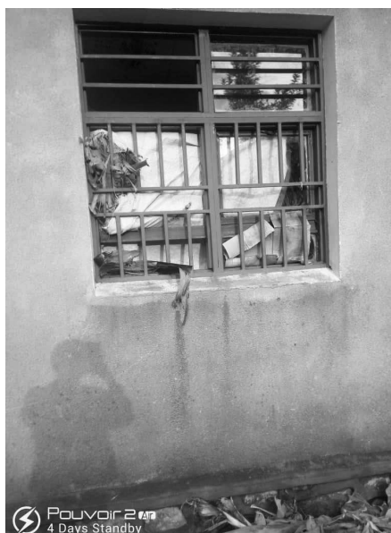
Fenêtre sans vitres au poste de Sarambwe
